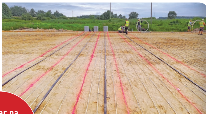
Czujniki 3DSensor u podstawy nasypu drogowego
