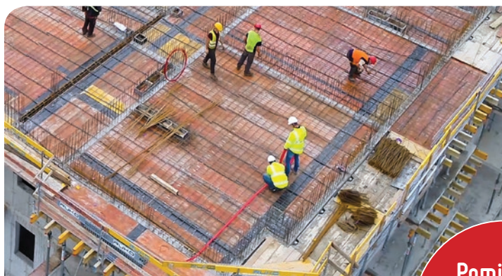
Instalacja 3DSensora w stropach budynku wielokondygnacyjnego
