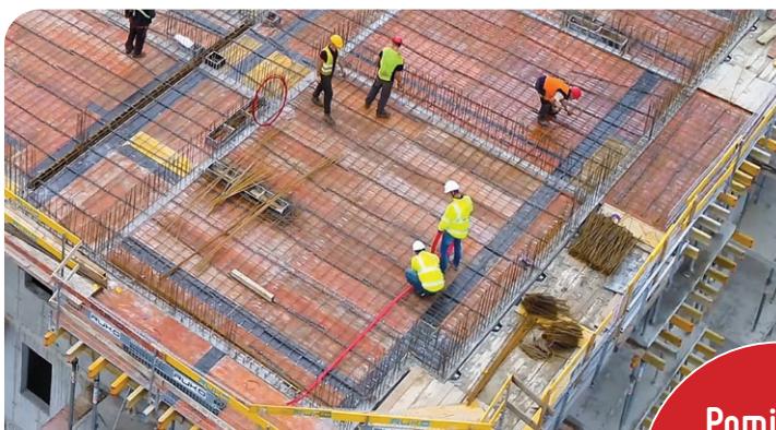
Instalacja 3DSensora w stropach budynku wielokondygnacyjnego
