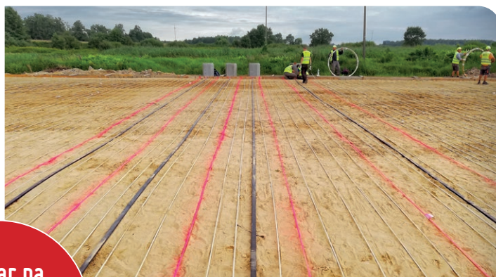
Czujniki 3DSensor u podstawy nasypu drogowego
