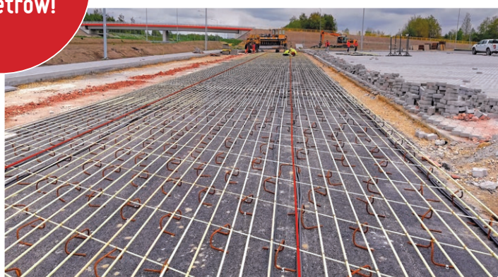
Czujniki EpsilonRebar w inteligentnej, betonowej autostradzie
