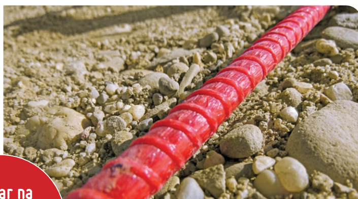
Nasyp drogowy z czujnikiem EpsilonRebar
